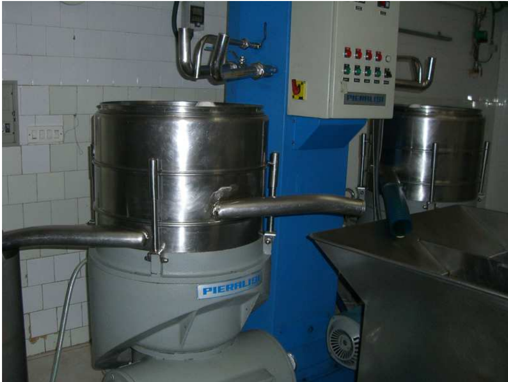
Centrifugadora vertical que separa el agua del aceite
