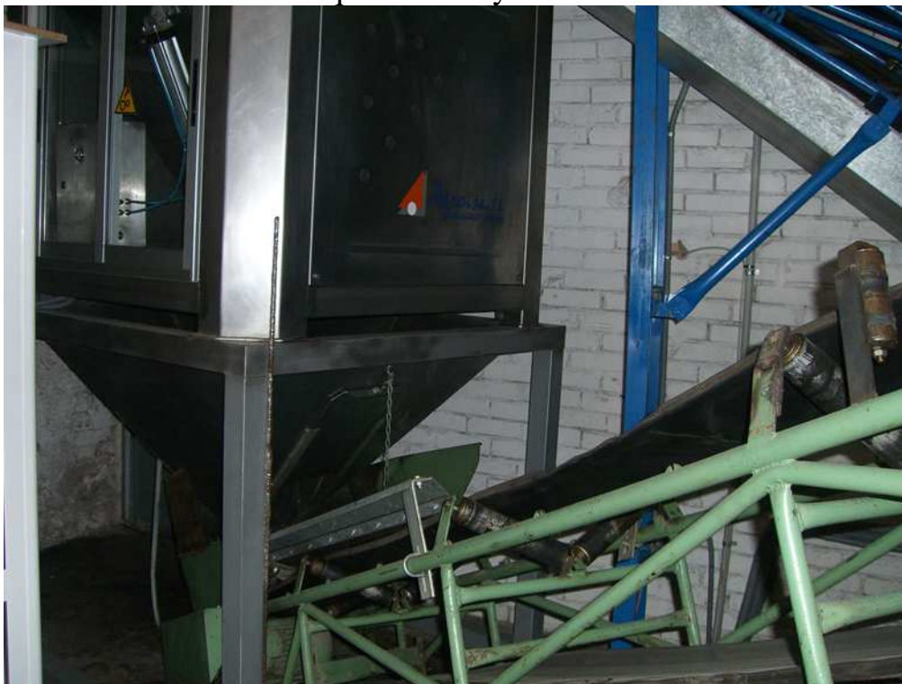
Instalación del proceso de separación de hojas, tallos y lavado de la aceituna para su almacenaje antes de la molienda
