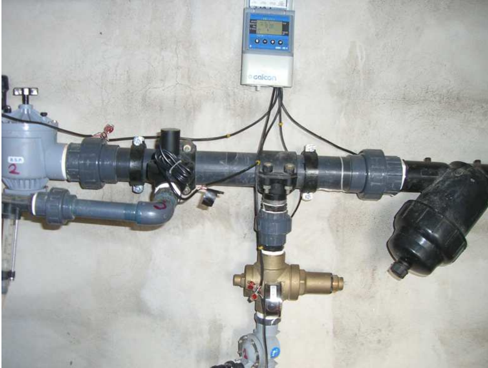
Automatismos del riego a goteo
