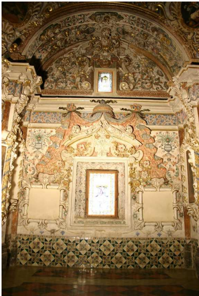
Pared del camarín, que da al exterior, antes de la restauración.
