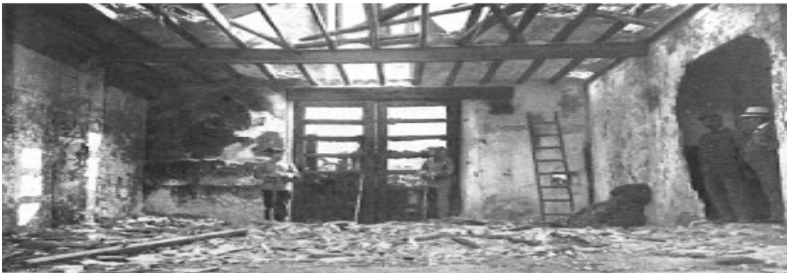
Estado en el que quedó el cine después de la tragedia.
