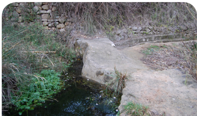
Salida del agua hacia la canalización
