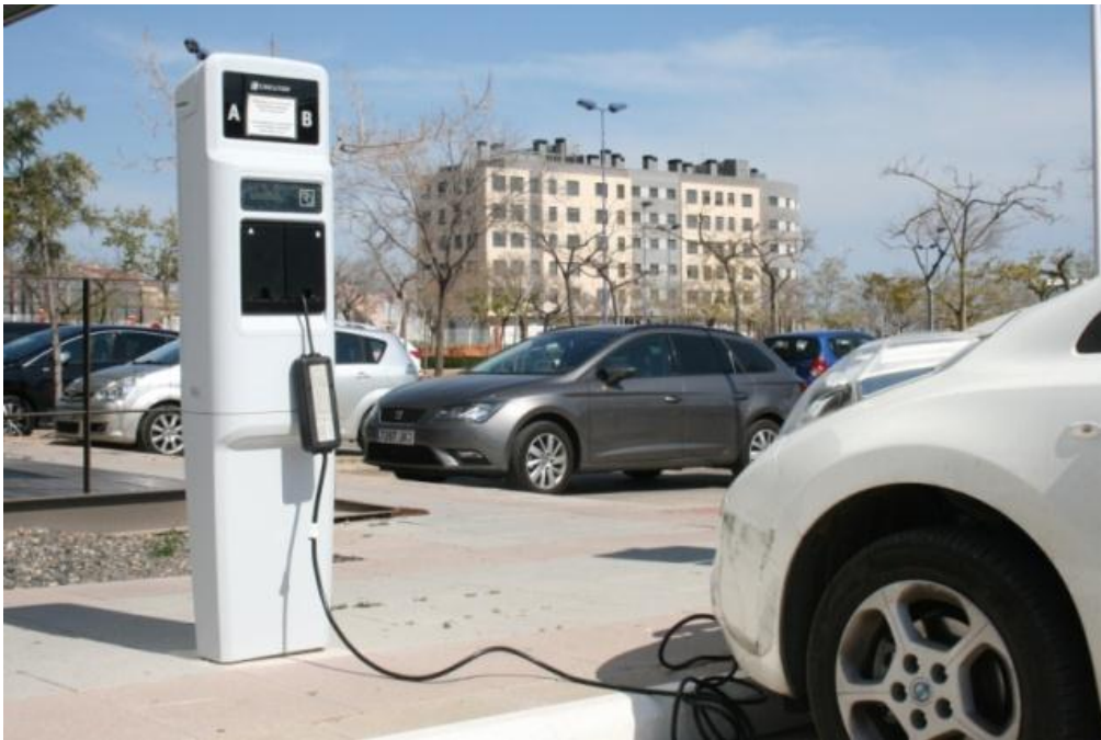
Poste de recarga de coche eléctrico en UJI Castellón
