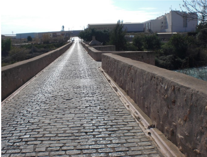
Calzada del puente medieval de Sta Quiteria en el Millars Foto del autor
